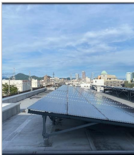
本社屋上の太陽光パネル
